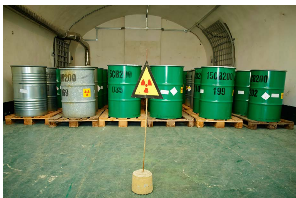
BĘBNY Z ODPADAMI SKŁADOWANE W KSOP
